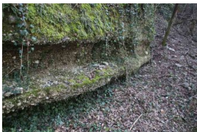
Alla base della parete si può vedere il fenomeno di erosione creato dal fiume Isonzo facilitato dalla presenza del conglomerato che compone l'intera scarpata.
