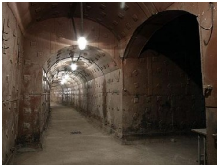
Fig. 12 – Un tratto delle estese gallerie a uso militare sotto la città di Mosca. Il sottosuolo della metropoli russa è costituito da rocce sciolte facilmente scavabili; nella foto si nota come questo recente "underground" sia caratterizzato da un rivestimento e consolidamenti semplicemente funzionali allo scopo.
