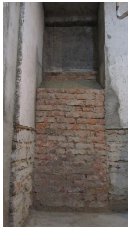
Fig. 11 - Tratto di muro del rifugio antiaereo non in cemento armato.
