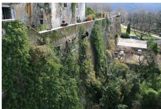
Fig. 69 - Durante i lavori di pulizia delle mura del Castello sono venute alla luce alcune aperture di possibili "camere" che erano occultate dall'imponente vegetazione.
