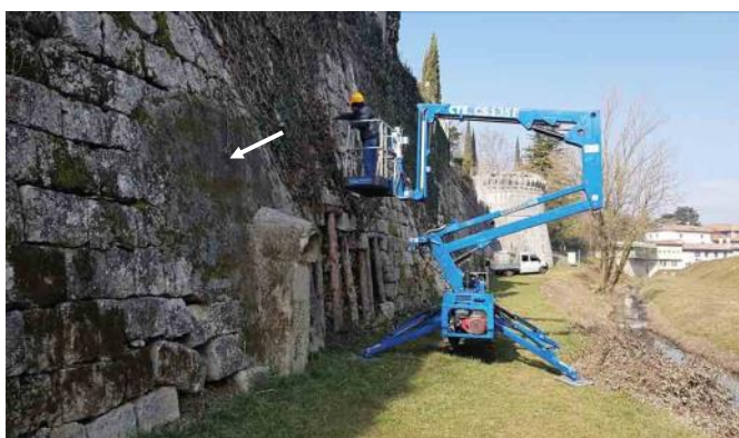
Fig. 120 - Dopo i lavori di pulizia sono venuti alla luce alcuni punti in cui si vede chiaramente come gli ingressi di vecchie gallerie siano stati chiusi e cementati in epoche recenti. Nel punto indicato dalla freccia esisteva l'ingresso di una galleria già percorsa negli anni '60 dallo scrivente.
