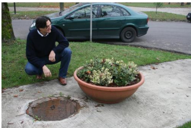
Fig. 43 - L'ingresso del Pozzo presso il Monumento ai Donatori di Sangue è chiuso da una botola in ferro che si trova sotto la grande fioriera (che qui vediamo è stata spostata).
