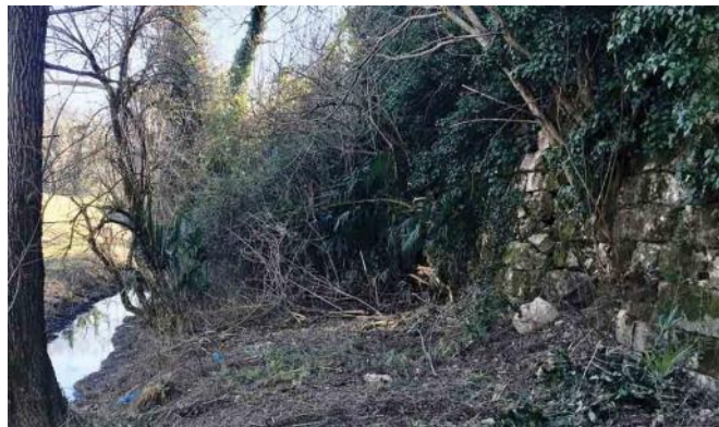
Fig. 117 - La vegetazione aveva invaso le mura provocando anche gravi danni strutturali.
