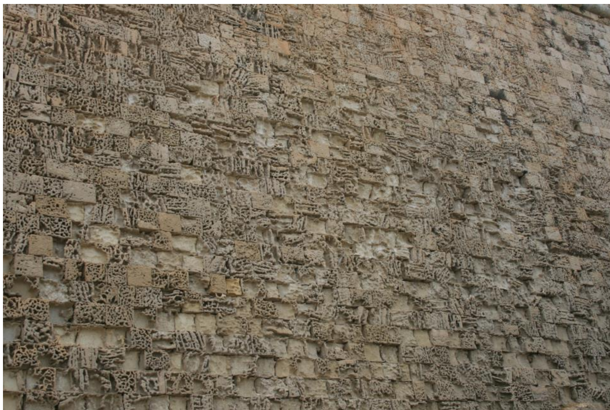
Fig. 58 - Sulle mura del castello di Victoria possiamo osservare un fenomeno abbastanza esteso di Salt weathering che possiamo ascrivere anche al “Salt-crystal growth”
