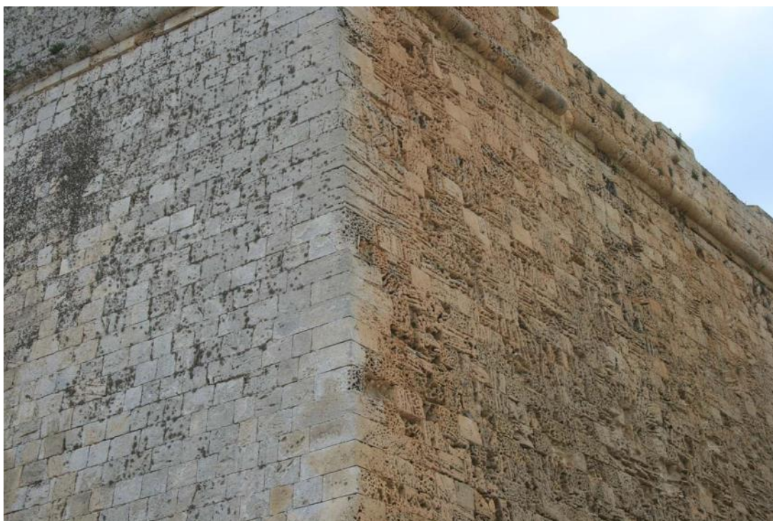
Fig. 59 - Un fenomeno di “Salt weathering” molto evidente lo si può vedere su una facciata del castello di Victoria. Qui possiamo osservare chiaramente che la parte esposta ai venti marini è completamente erosa con forme di alterazione molto evidenti, mentre la parte sottovento risulta integra.
